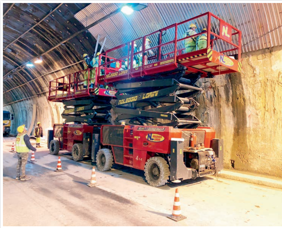
Für die Tunnelrenovierung hat sich del Bono aus Brescia aufgrund ihrer Eigenschaften für drei Magni-Arbeitsbühnen aus der Mietflotte von Lorini Noleggi entschieden. Foto: Magni
